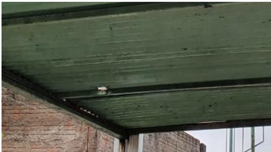
Foto 4 – furo na cobertura
